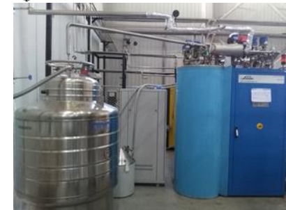
TCF10 Liquefier Unit
